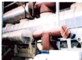
Trockner in der Trocknungsanlage
